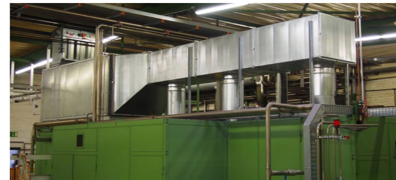
Die neue Wärmerückgewinnungsanlage reduziert den Heizenergiebedarf deutlich.
